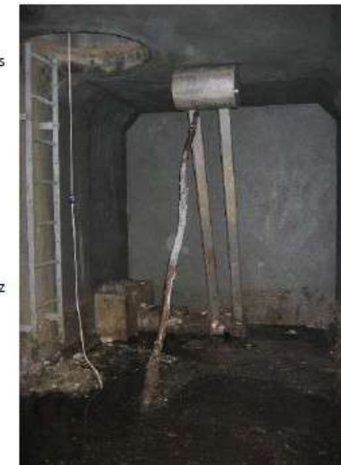
Détail de l'organe de régulation (vanne à flotteur) d'un ouvrage de stockage enterré.
